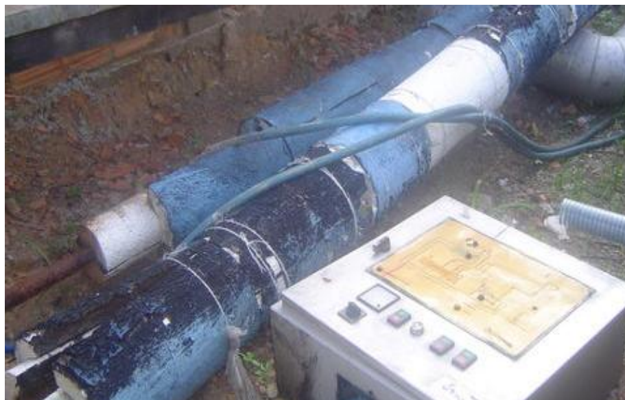
Figura 19: Fábrica de gelo destruída no pátio da SINFRA Fonte: CPI Z-29, 2004
