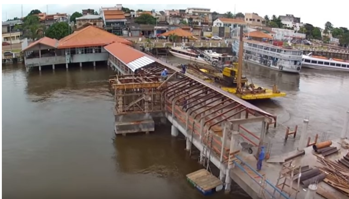
Figura 75 – Imagem aérea da reforma e ampliação do hidroviário na orla de Itaituba, em 2014
